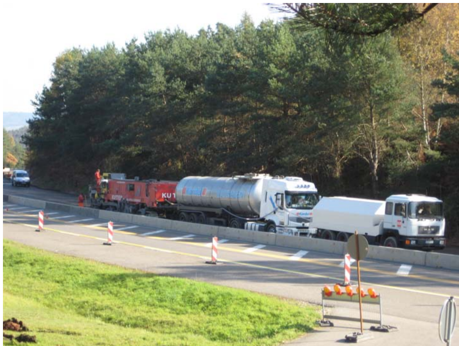
Bild 22 Gerätekomplex für Kaltrecycling in situ - Wassertankfahrzeug, Tanker für Bitumenemulsion und Recycler WR 4200
