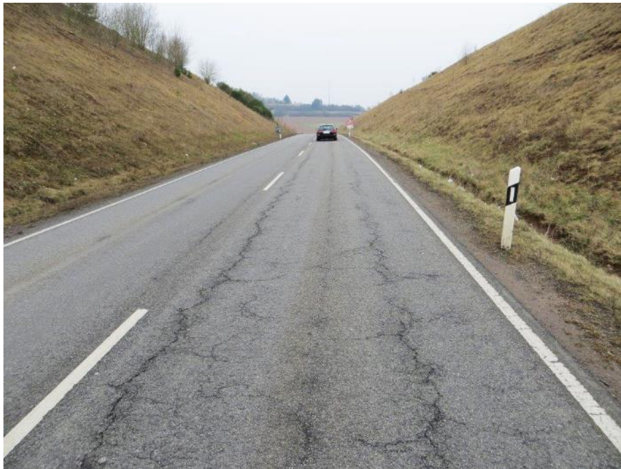
Bild 5: DSK-mAZ auf der B 270 Erfenbach Schäden 2013
