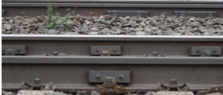
Abbildung 5.2: Schienenstegdämpfer unterschiedlicher Bauart in Koblenz
