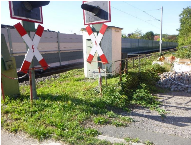
Abbildung 3: Schalthaus im II. Quadranten. Der Neubau findet auf dem angrenzenden Lagerplatz statt.
